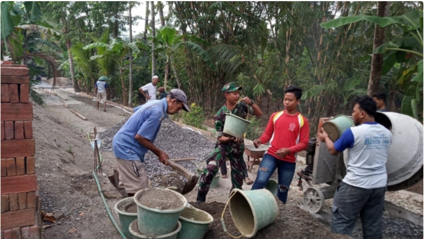
Peltu Donny Eko P bersama warga melaksanakan kegiatan kerjabakti pengecoran jalan di lingkungan RT 03 RW 4 Desa Karangduwur
